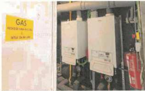
Sala de calderas de una comunidad de vecinos de la capital, a. roscas
